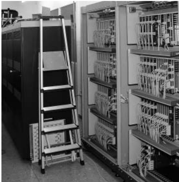
Alte (links mit Leiter) und neue Anlage (rechts) machen Bekanntschaft
