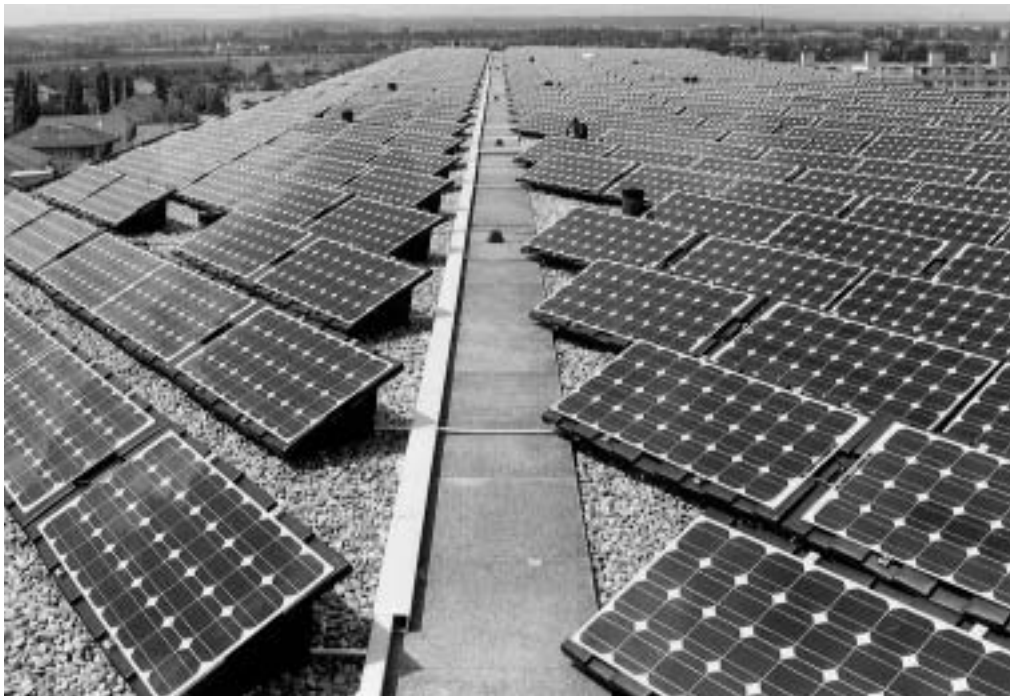
Foto: ADEV Solarstrom AG, Liestal
