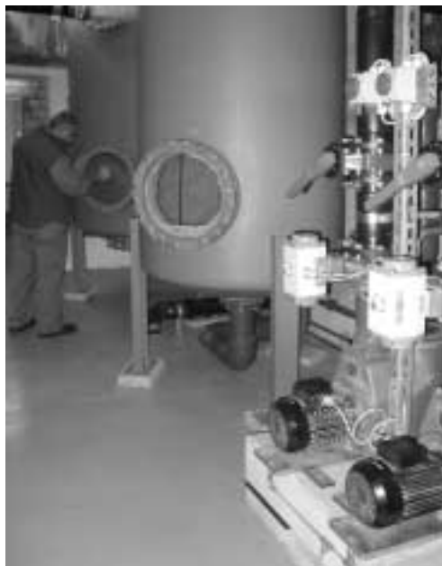
Isa Güvenc bei der Wasseraufbereitungsanlage im Keller, Hauptgebäude
